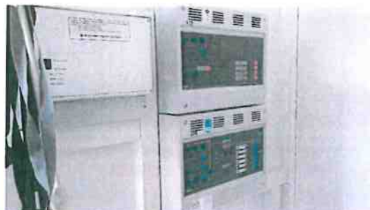
Centrale alarme incendie
