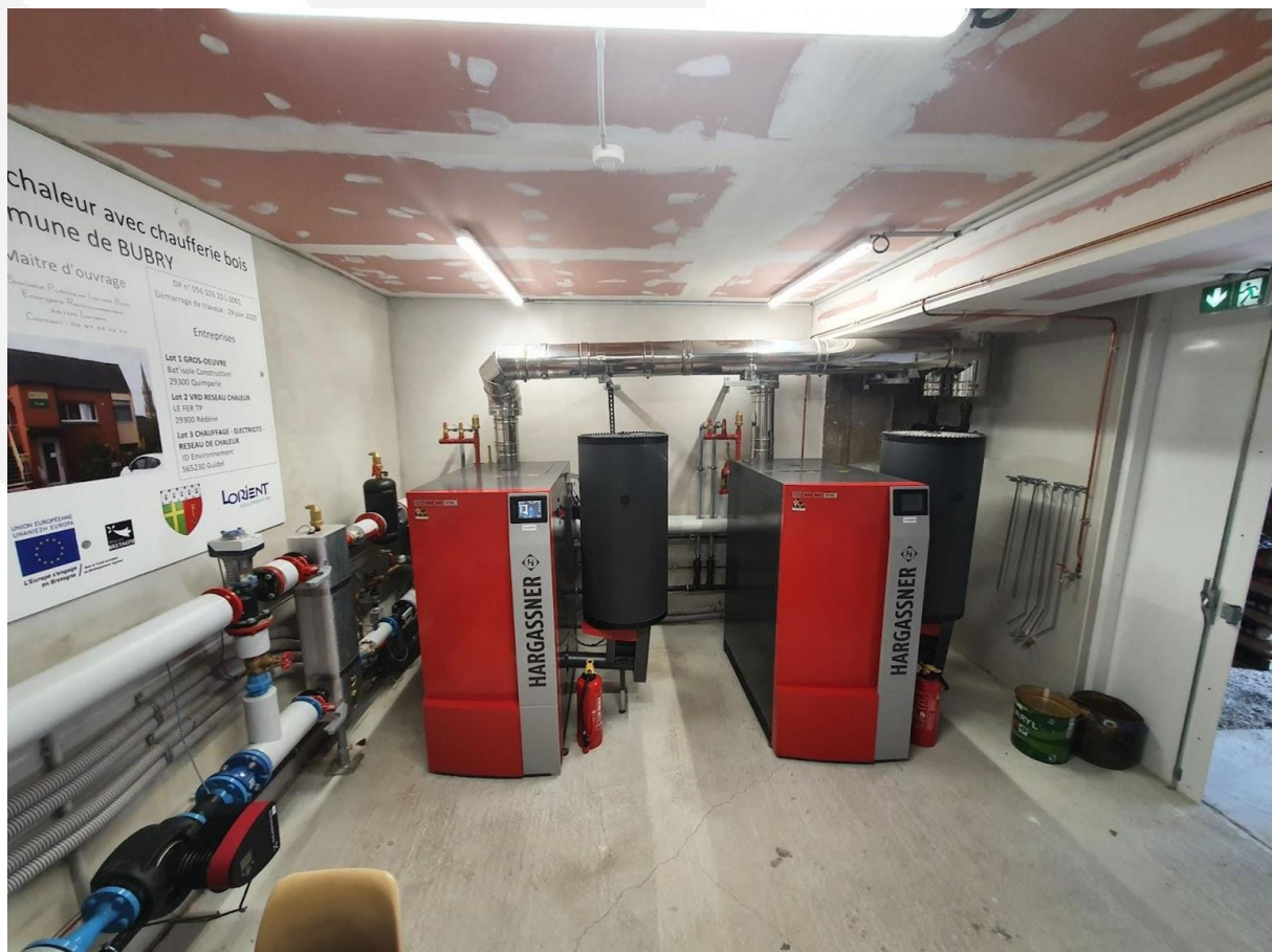
Chaufferie à Bubry
